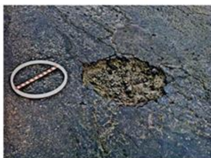
Figura 3.15 - Panela ou buraco. Fonte: DNIT 2003.
