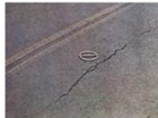
Figura 3.6 - Trinca isolada transversal. Fonte: DNIT 2003.
