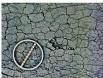
Figura 3.7 - Trinca interligada tipo couro de jacaré. Fonte: DNIT 2003.
