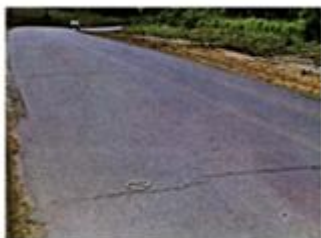
Figura 3.5 - Trinca isolada transversal. Fonte: DNIT 2003.
