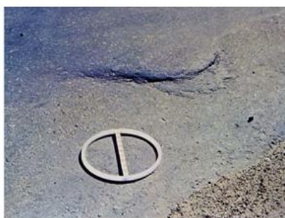
Figura 3.12 - Escorregamento. Fonte: DNIT 2003.
