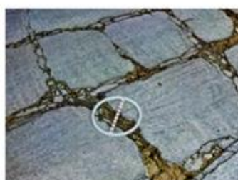
Figura 3.8 - Trinca interligada tipo bloco. Fonte: DNIT 2003.
